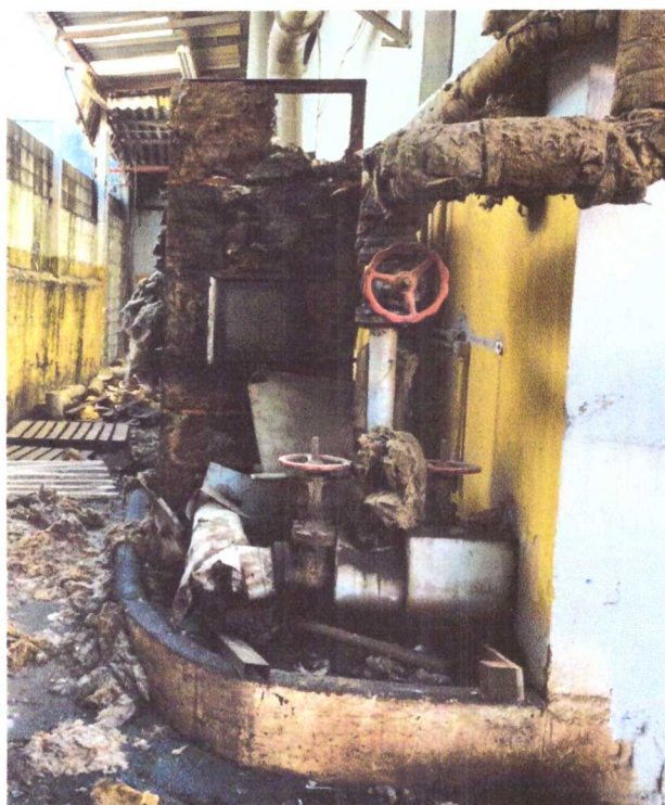
Vista do Aquecedor de Fluido Térmico Cap. 400.000 Kcal/h classificado como máquina e equipamento mutilado
