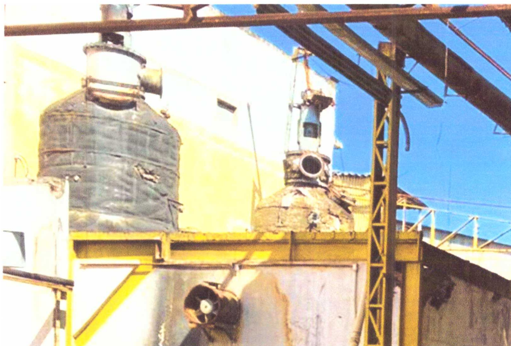
Vista dos 02 Reatores Químicos de Capacidade de 10,0 m 3 classificado como máquina e equipamento mutilado
