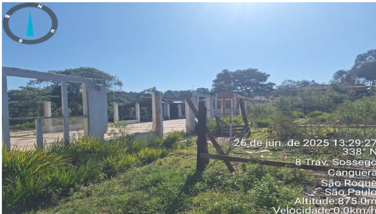
Foto 7 – Antigo espaço do restaurante (demolido) e cerca de divisa (deteriorada)
