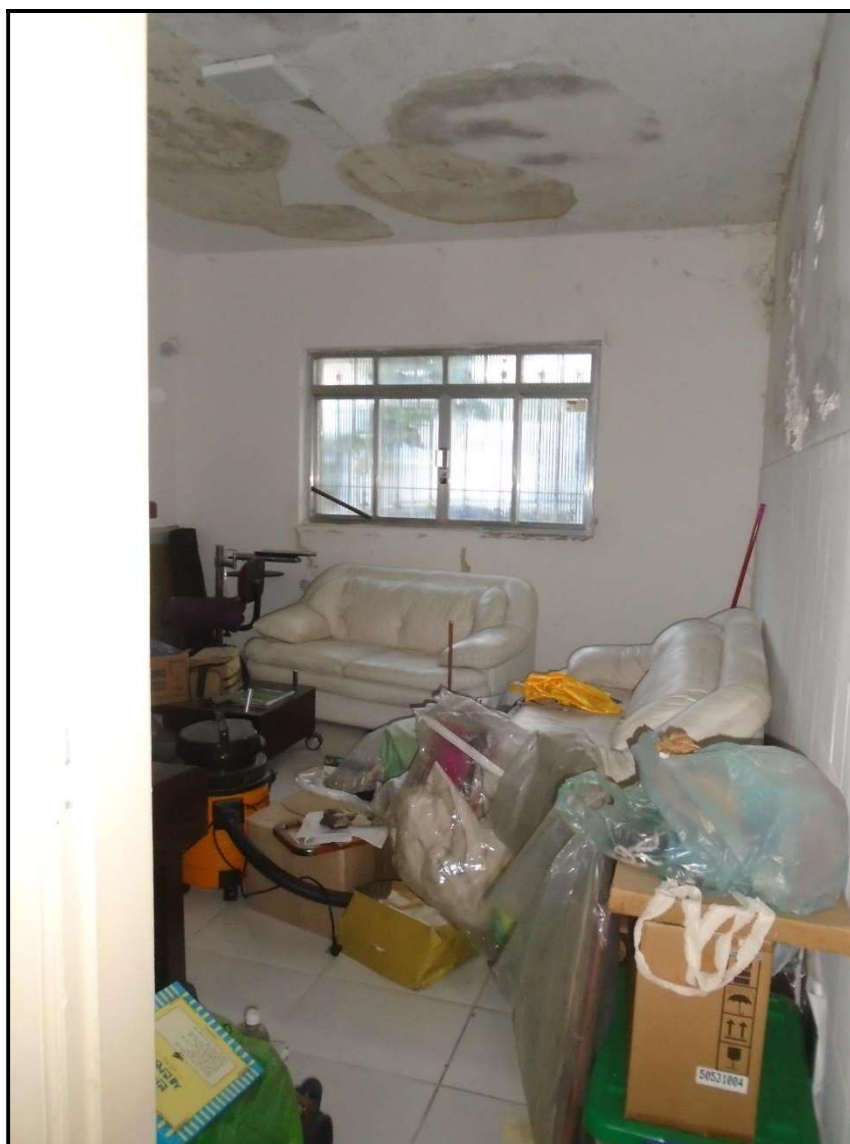
FOTO Nº09 .ASPECTO MANCHAS PAREDES TETO E SALA
