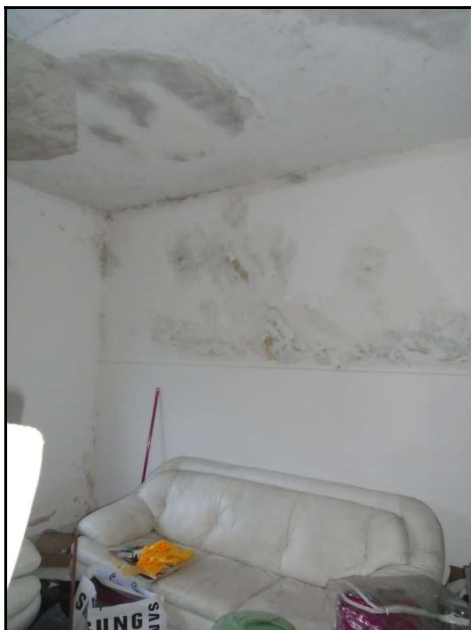
FOTO Nº10: DETALHE DA DETERIORAÇÃO ARGAMASSA.
