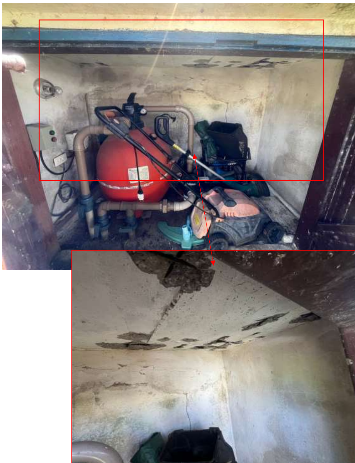
Foto 20 – Vista geral da casa de bombas da piscina. Constatação de abrigo clandestino e obsoleto, uma vez que há comprometimento da estrutura da laje e alvenaria/revestimento. Foi possível verificar falta de manutenção, destacamento de concreto e oxidação de armaduras, conforme marcação em vermelho.
