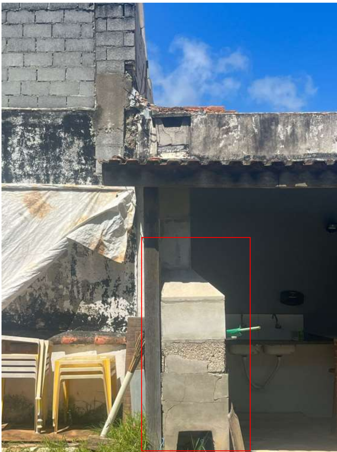
Foto 15 – Detalhe da churrasqueira com fim da vida útil, conforme marcação em vermelho, outro ângulo.
