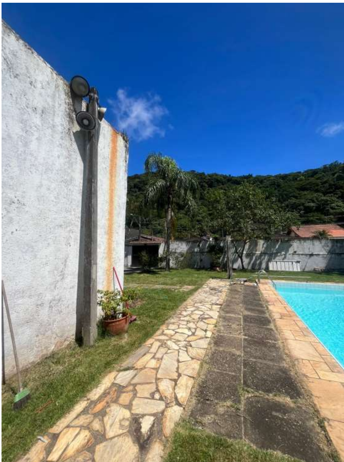
Foto 7 – Detalhe do terreno objeto desta avaliação, outro ângulo. Constatação de edificações clandestinas e obsoletas.
