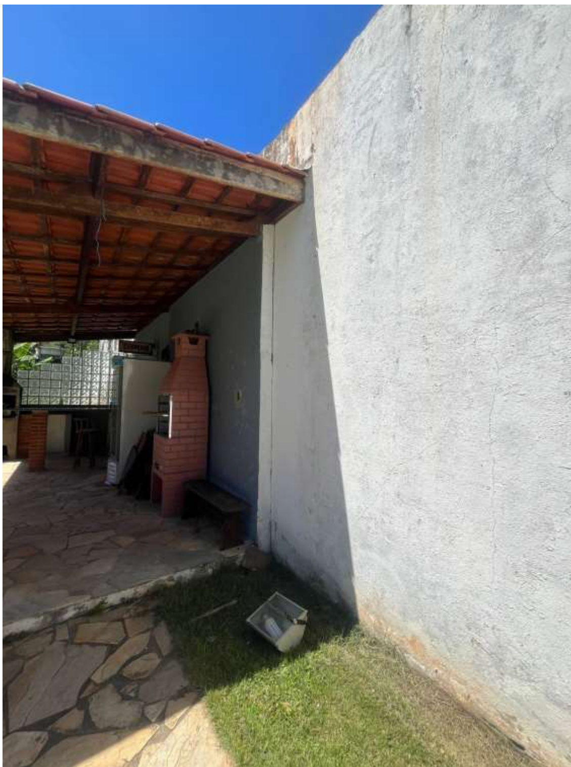
Foto 16 – Vista geral da churrasqueira com destacamento do muro divisorio.
