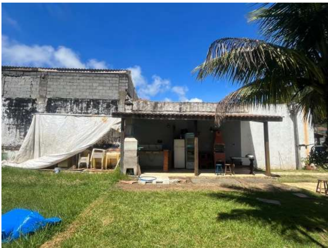
Foto 12 – Vista geral da área da churrasqueira com cobertura – construção clandestina e obsoleta.
