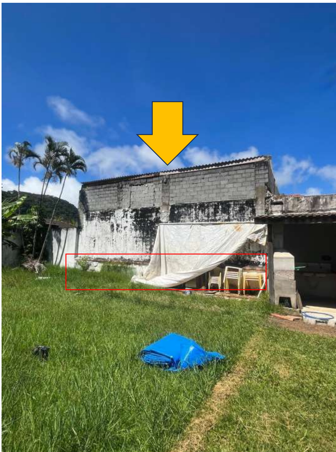
Foto 18 – Vista geral do muro de divisa com aproximadamente 40cm de altura, conforme marcação em vermelho, localizado na parte dos fundos, lateral direita de quem olha para o terreno.
