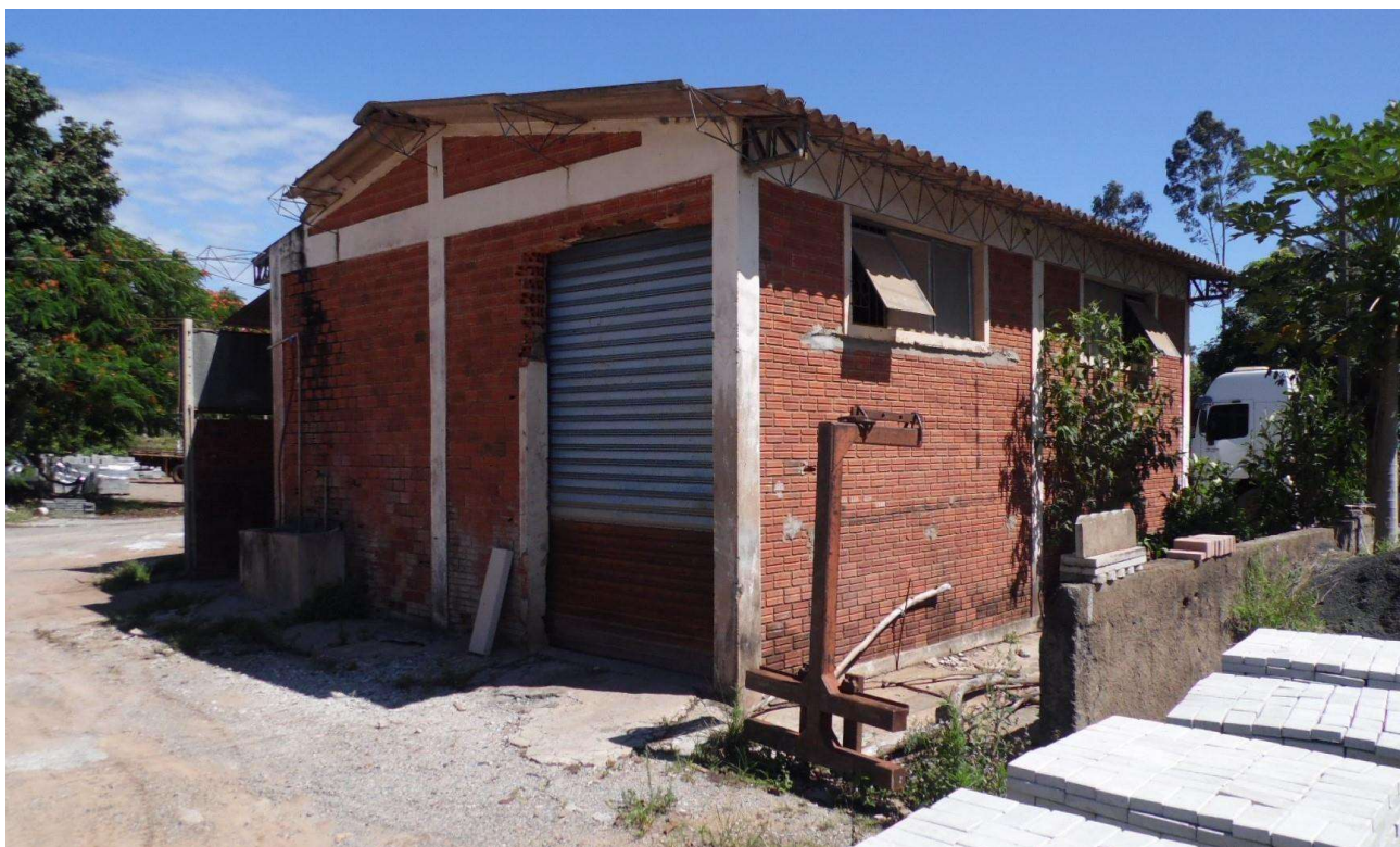
Imagem 15 – Galpão Oficina - área construída aproximada de 60.00 m2, construção antiga e negligenciada em relação a conservação/manutenção, o que reduz o seu valor de mercado.
