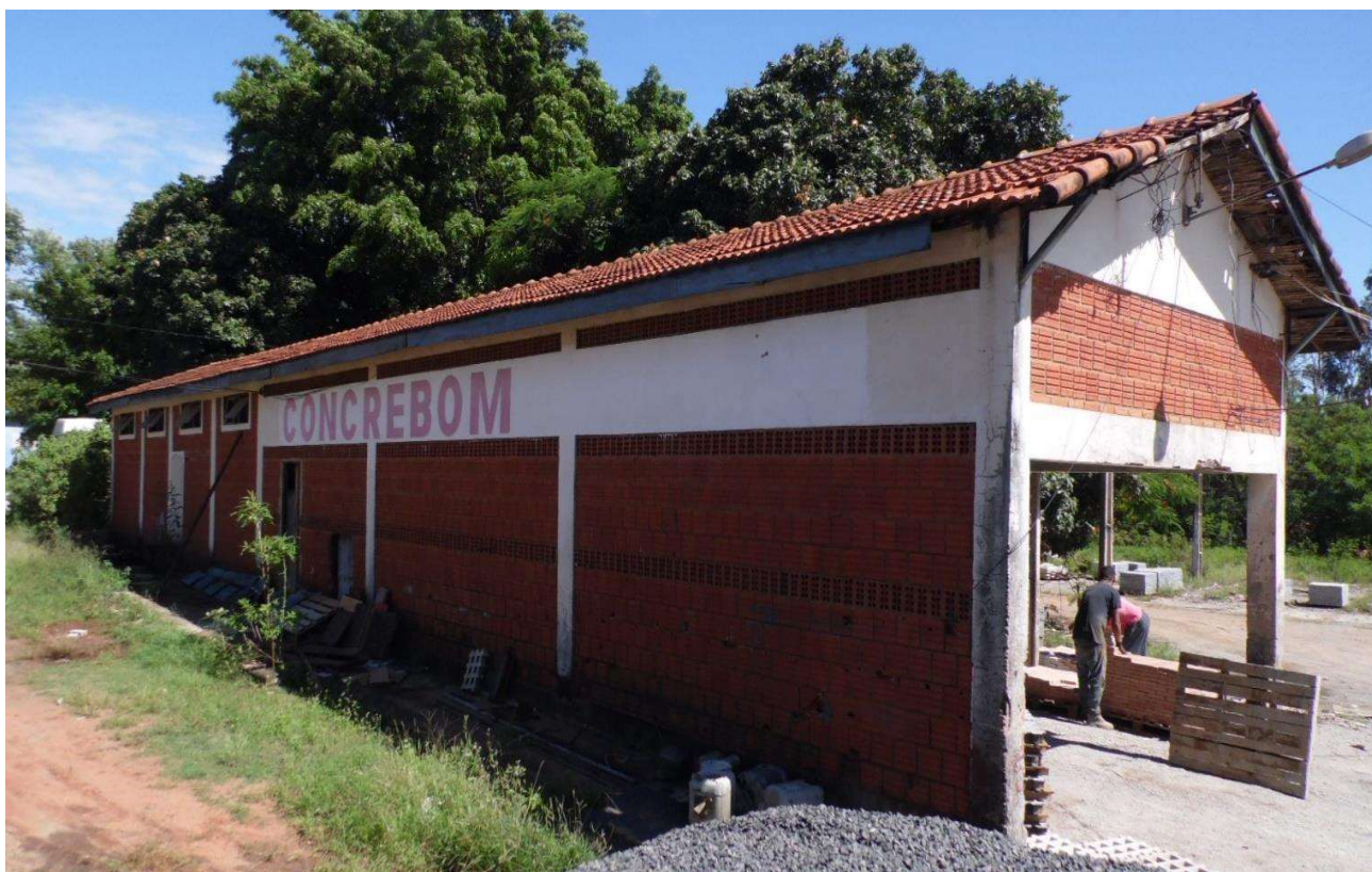
Imagem 12 – Galpão de trabalho - área construída aproximada de 120.00 m 2 , construção antiga e negligenciada em relação a conservação/manutenção, o que reduz o seu valor de mercado.
