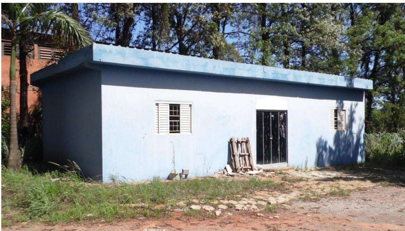
Imagem 21 – Escritório Administrativo - área construída aproximada de 50.00 m2, mesmo sendo a construção menos antiga do local também está negligenciado na conservação/manutenção.
