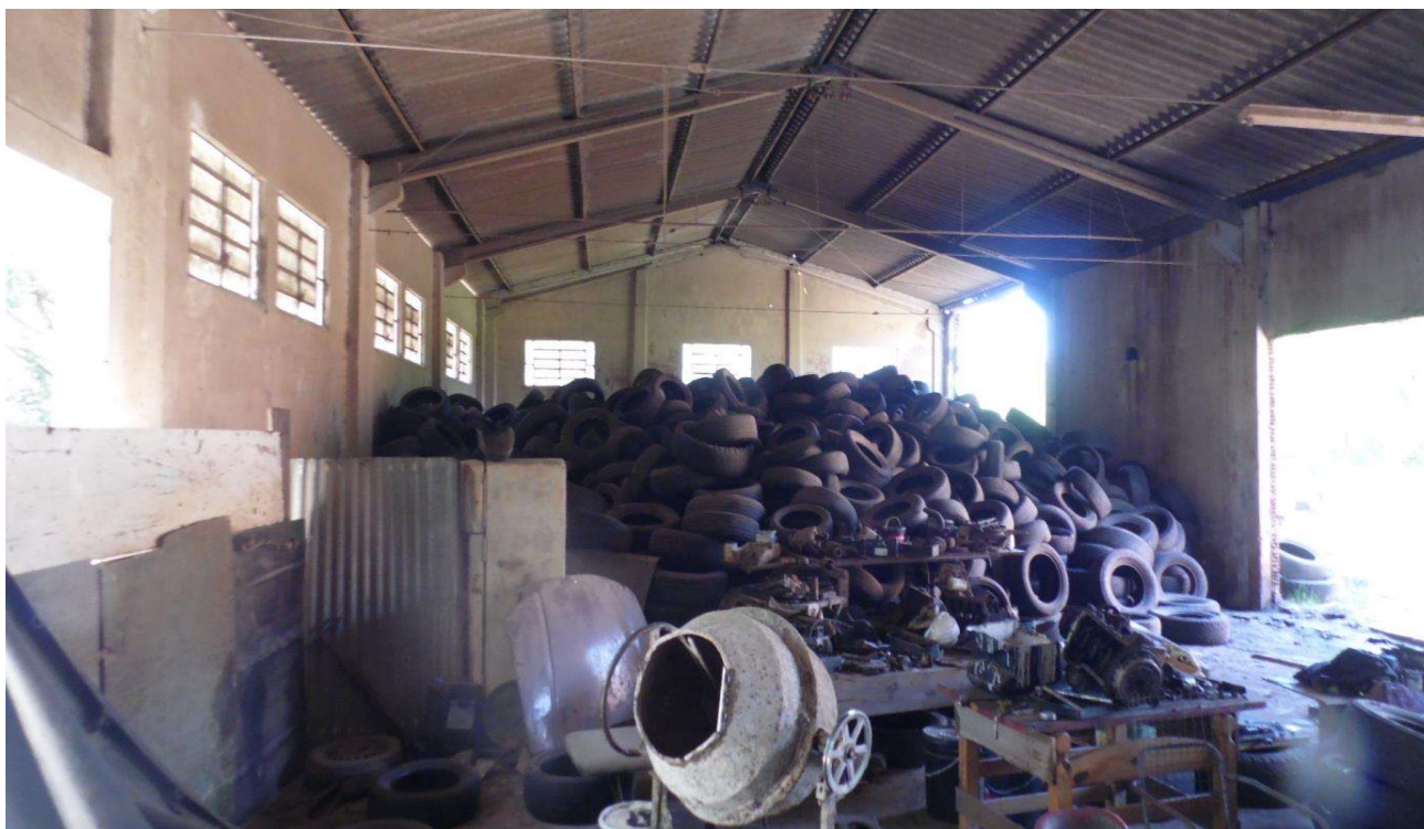
Imagem 23 – Interior do Galpão de Jateamento de areia - piso de concreto, pé-direito de 6.00 m, cobertura com telhas de fibrocimento e fechamento em alvenaria, com muitos objetos e pneus para reciclagem, negligenciado em relação a conservação/manutenção e com valor reduzido.
