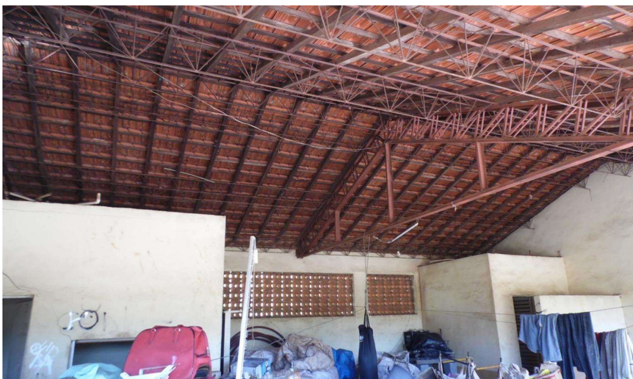
Imagem 18 – Interior do Galpão de reciclagem - piso de concreto, pé-direito de 3.50 m, cobertura com telhas de barro e fechamento em alvenaria, negligenciado na conservação/manutenção.
