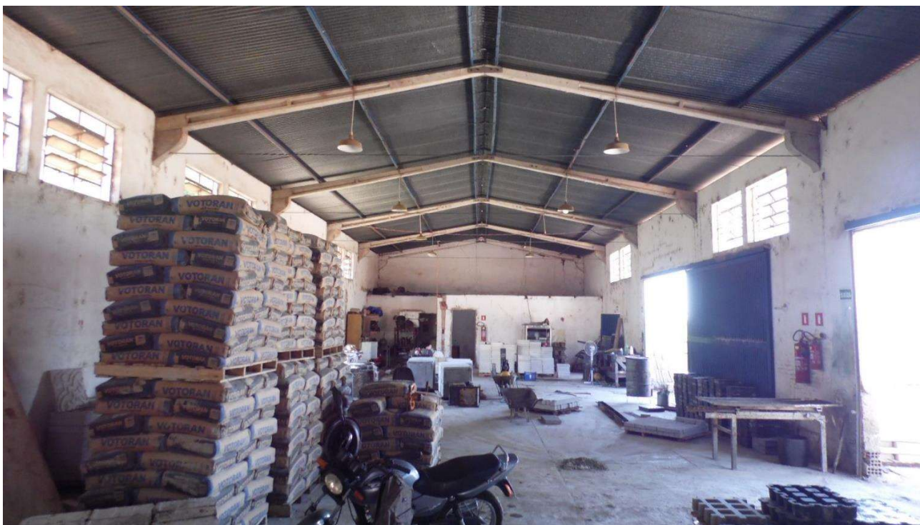
Imagem 11 – Interior do Galpão Administrativo - piso de concreto, pé-direito de 6.00 m, cobertura com telhas metálicas e fechamento em alvenaria, negligenciado na conservação/manutenção.
