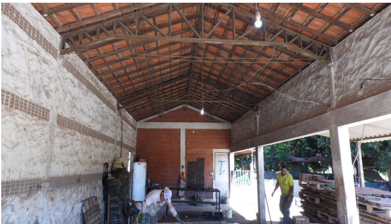
Imagem 14 – Interior do Galpão de trabalho - piso de concreto, pé-direito de 4.00 m, cobertura com telhas de barro e fechamento em alvenaria, negligenciado na conservação/manutenção.
