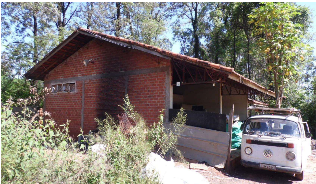
Imagem 17 – Galpão de reciclagem - área construída aproximada de 115.00 m 2 , construção antiga e negligenciada em relação a conservação/manutenção, valor de mercado reduzido.
