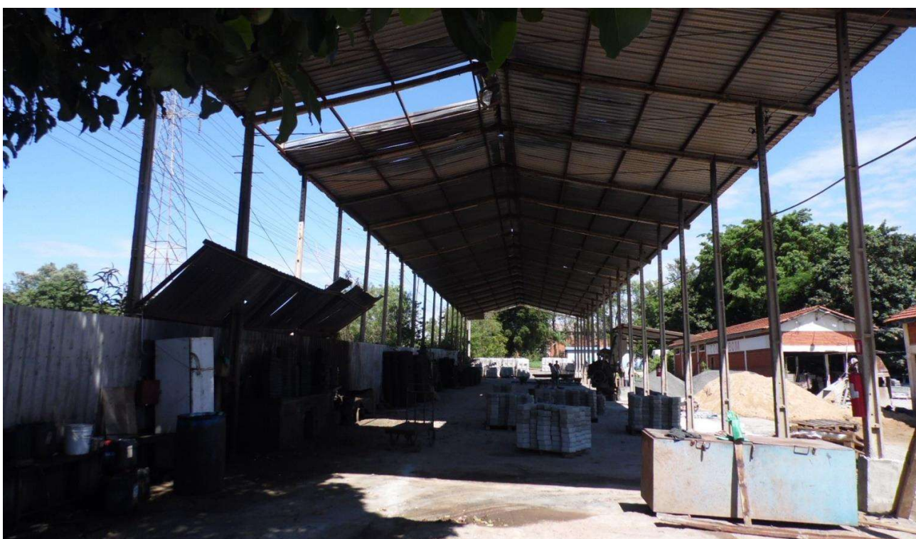
Imagem 20 – Interior Cobertura de trabalho - piso de concreto, pé-direito de 8.00 m, cobertura com telhas metálicas e sem fechamento lateral, negligenciada na conservação/manutenção.
