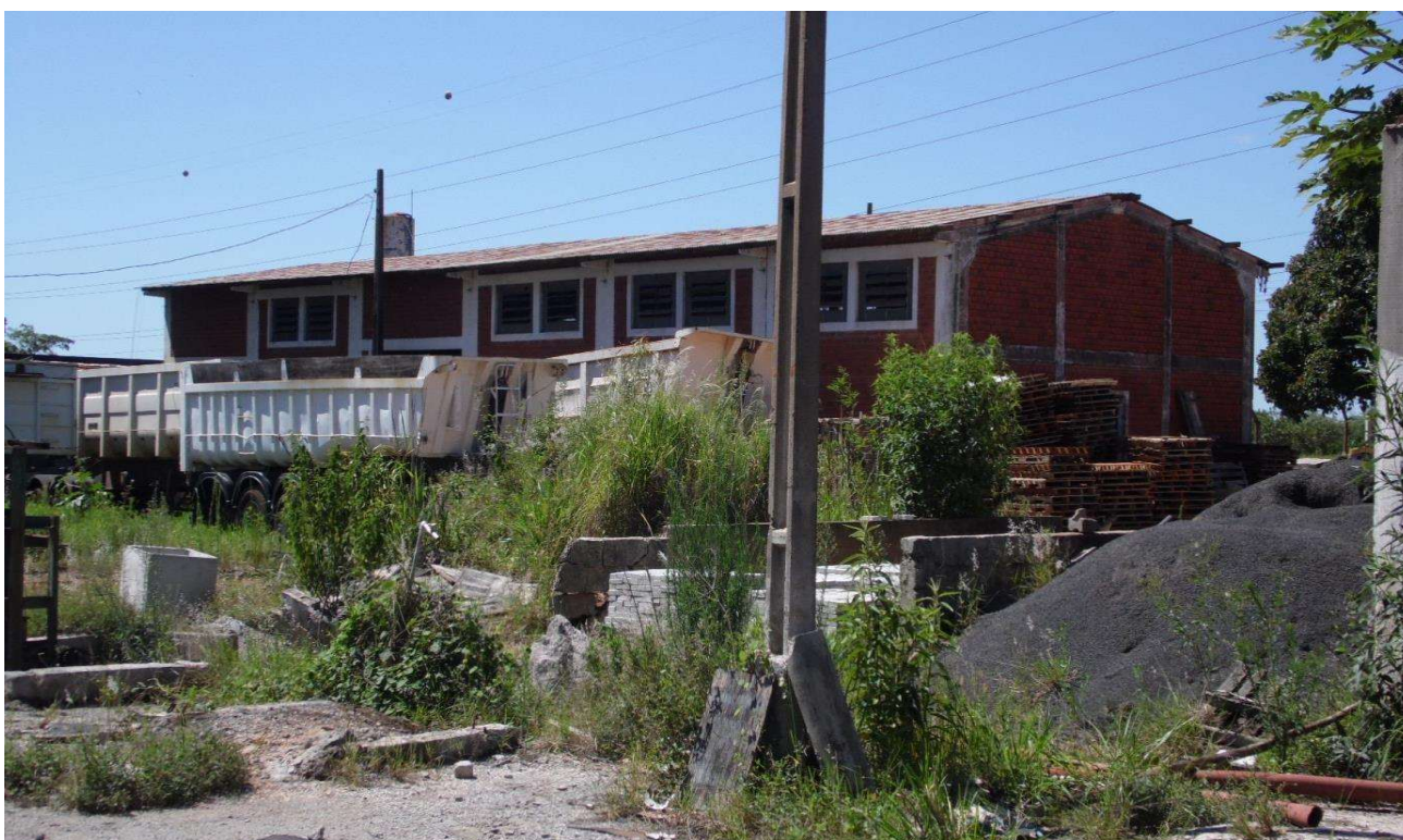
Imagem 10 – Galpão Administrativo - área construída aproximada de 235.00 m2, no entanto, trata-se de uma construção antiga e negligenciada em relação a conservação/manutenção.
