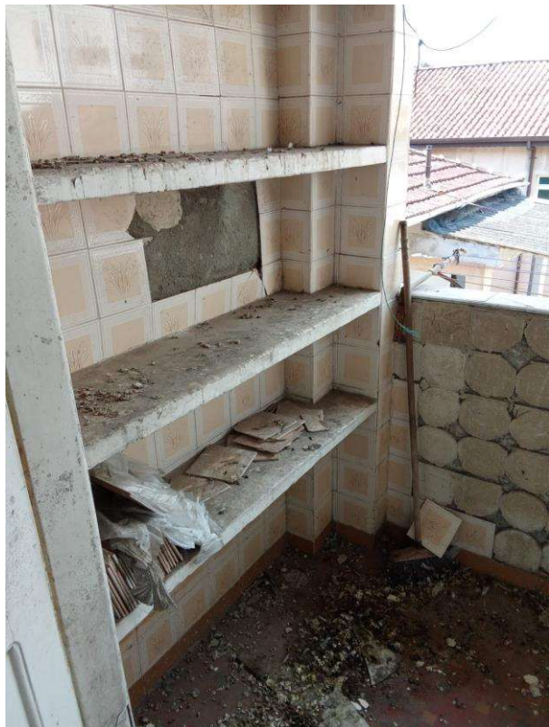
Vista da Area de Serviço com porta danificada
