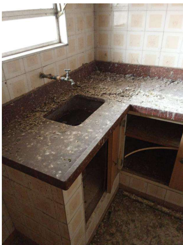
Vista da Pia com Ausência da Cuba
