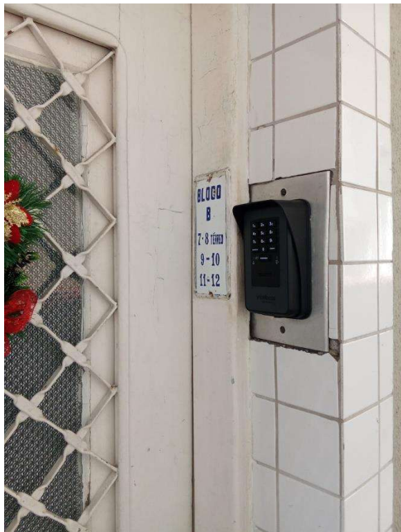
Interfone na porta de acesso ao Bloco B
