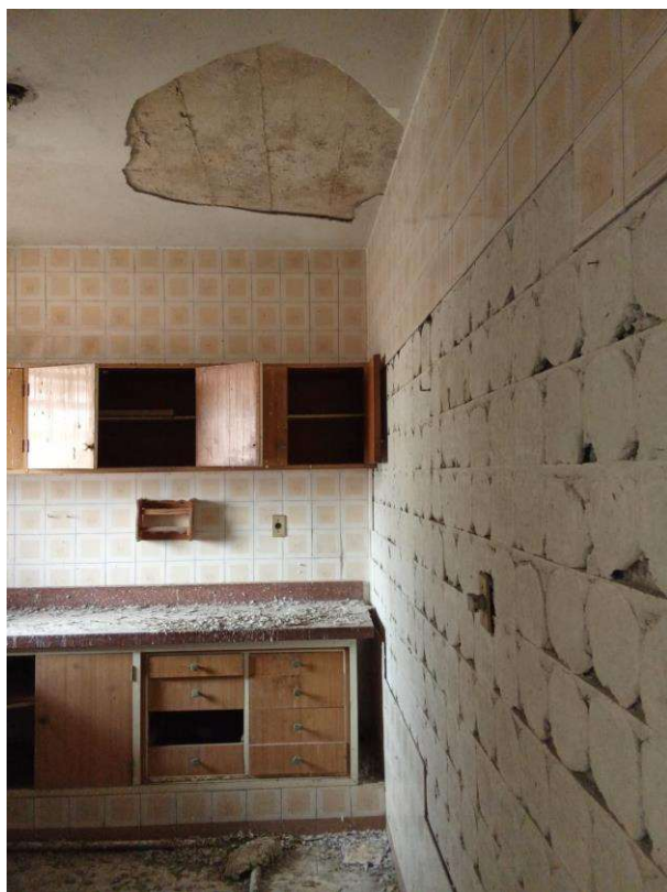
Teto da Cozinha com reboco ausente
