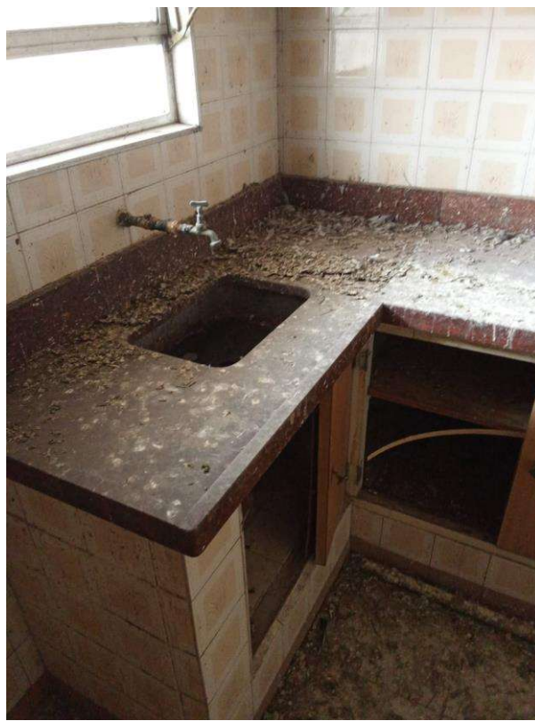
Armários da cozinha danificados
