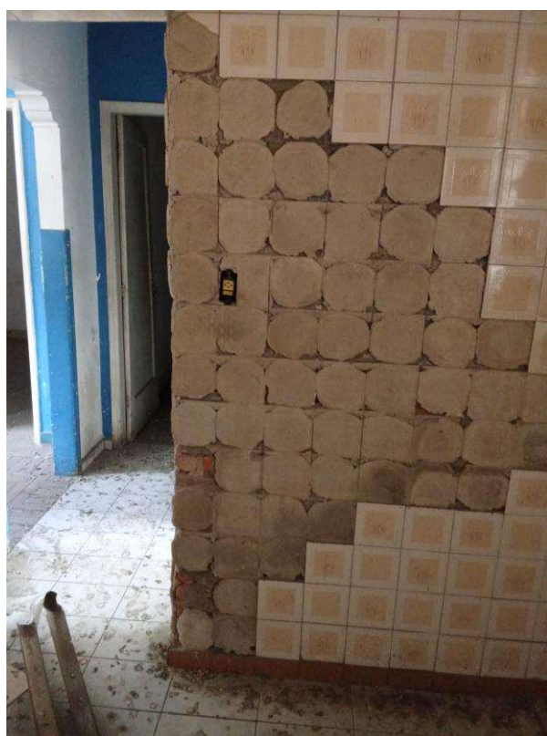
Vista da Cozinha com ausência de azulejos
