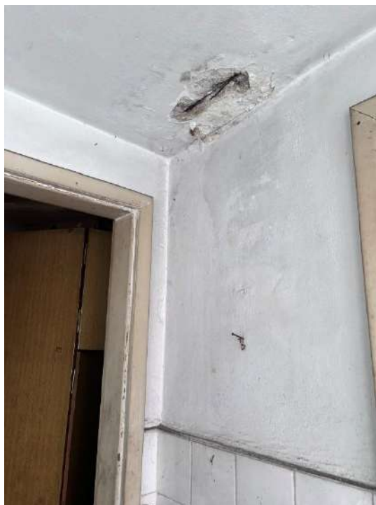
Foto 17: Infiltração e danos na laje
