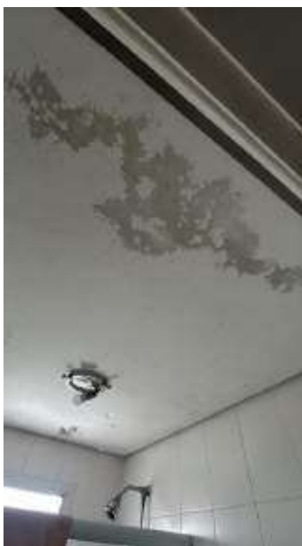
FOTO 12 - BANHEIRO 1 DA SUÍTE 1 COM DETALHES DE MANCHAS DE UMIDADE
